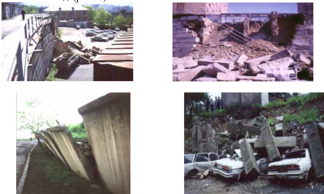
Рис.18. Примеры разрушения подпорных стенок
